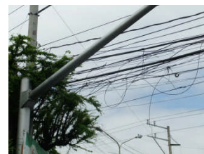
絡まった電線があちらこちら
